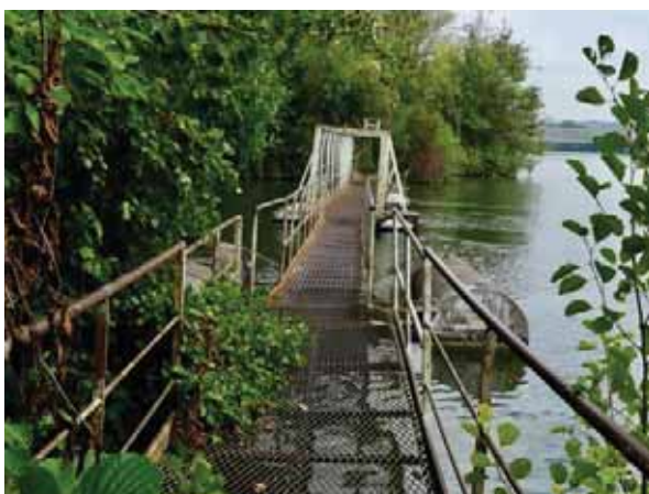
12. Passerelle à reconstruire (photo E. Marchandise)
