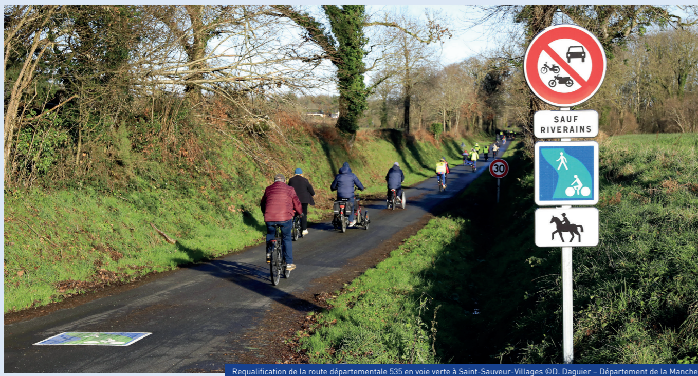
Requalification de la route départementale 535 en voie verte à Saint-Sauveur-Villages ©D. Daguier - Département de la Manche
